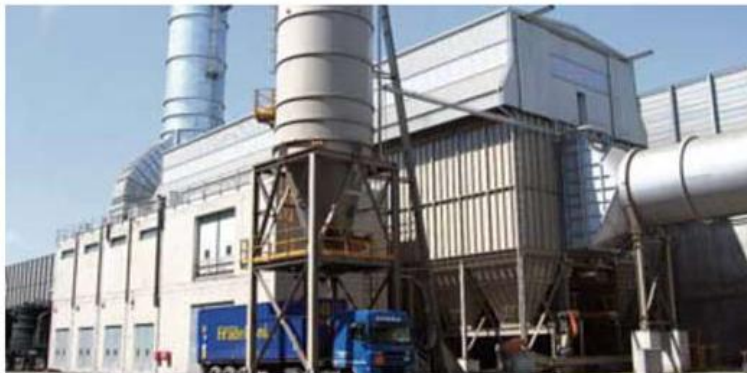
Un impianto abbattimento fumi da forni elettrici realizzato da Comeca
